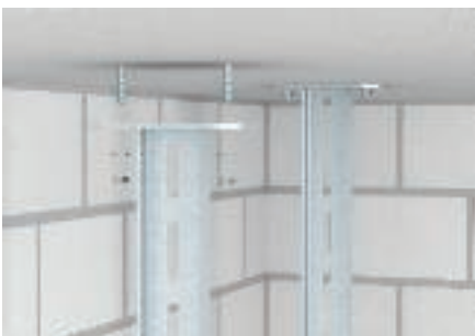
Standardmontering av takpendler i betongtak ved hjelp av boltanker type FAZ II.
