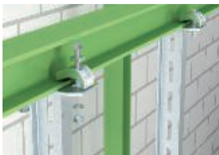
Direkte stålklemmeinnfesting av I-takpendel ved hjelp av kraftig spennklo TKS-S-30. Traseen går i stålbærerens retning.
